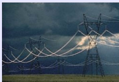
Lignes à haute-tension
